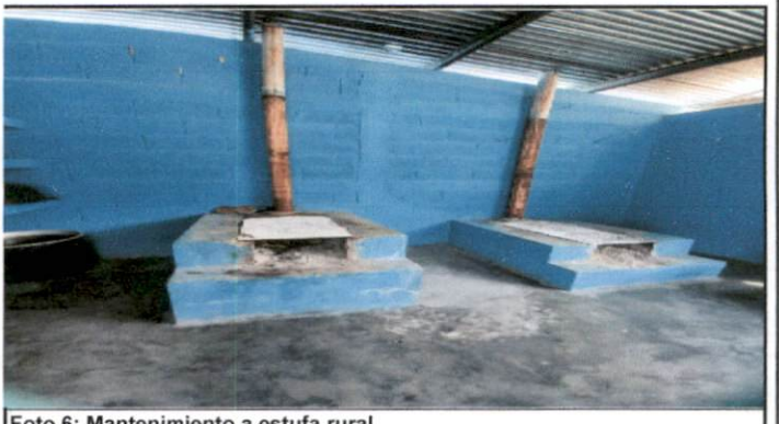
Foto 6: Mantenimiento a estufa rural
